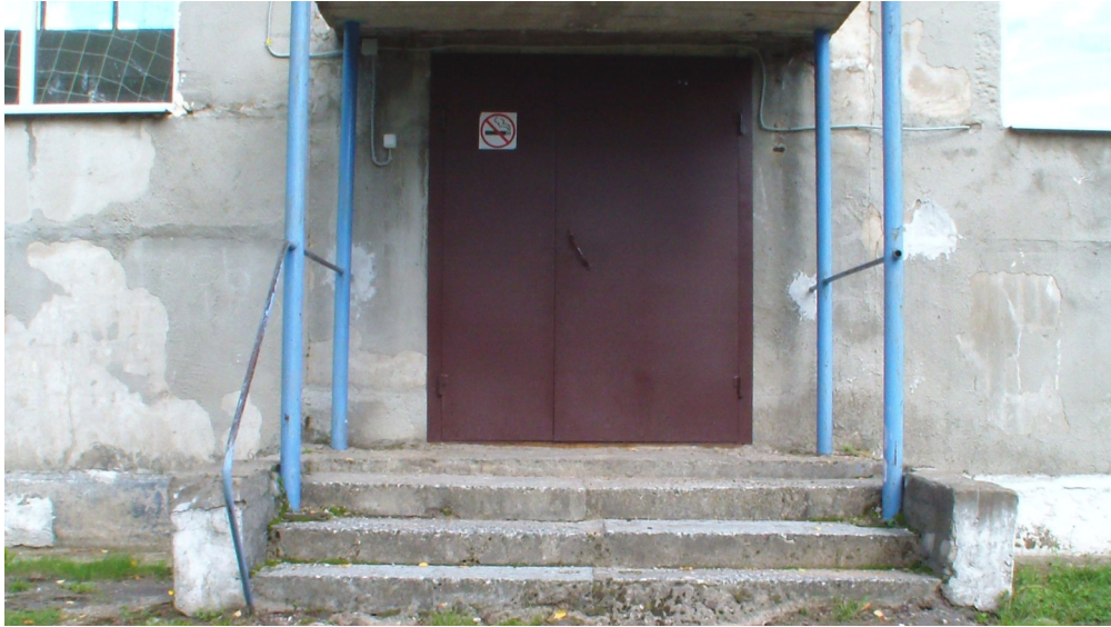
Эвакуационный выход из спортзала
